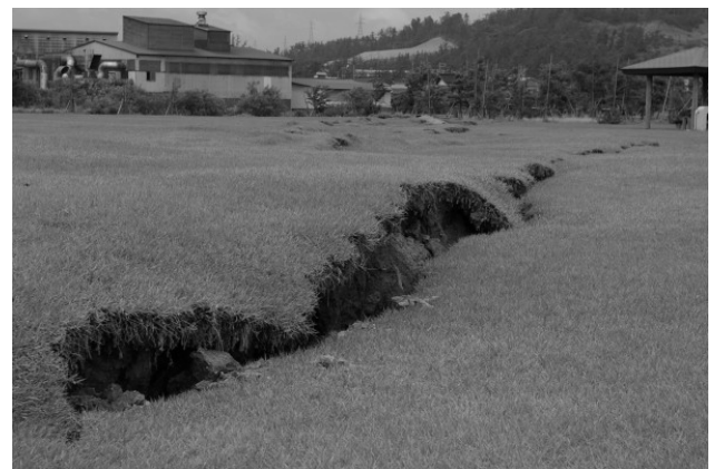
写真-1 新潟中越沖地震（2004）による被害例
