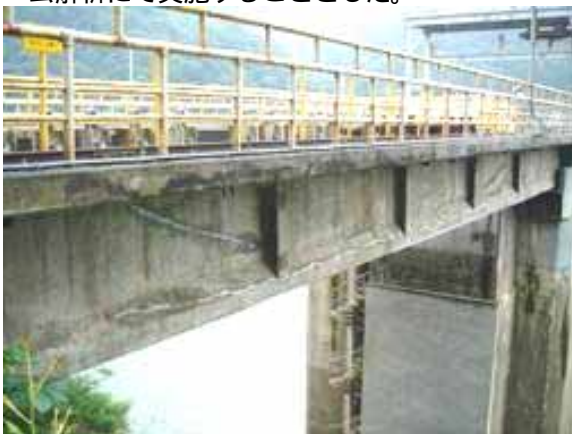
写真-1 主桁側面PC鋼材配置位置に沿った遊離石灰発生
