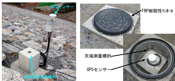
(a) 堤体法面での設置 (b) ダム天端での設置
