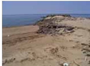
Fig.2 第6突堤根元部 (赤川寄り)
