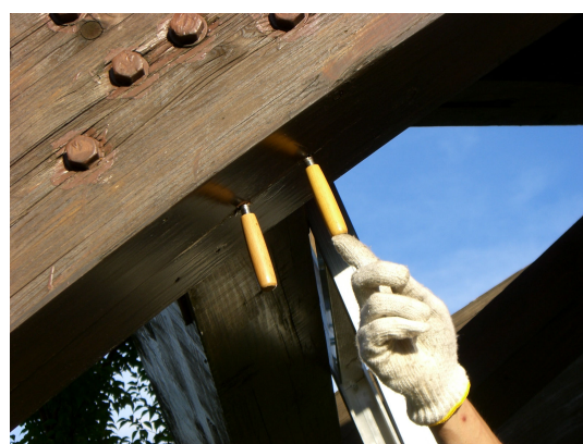
写真-2 2号橋アーチ部の劣化状況
