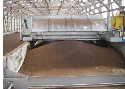
写真-1 ロータリー式攪拌 (施設 A)
