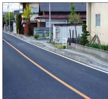
図－1（歩道波打状況）
