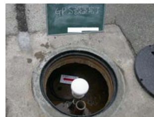
(a) マンホール内の GPS センサー
