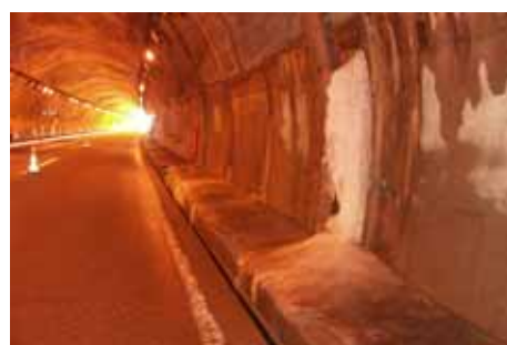
写真-3 トンネル湧水部での氷盤
