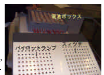
図3 電磁石制御盤
