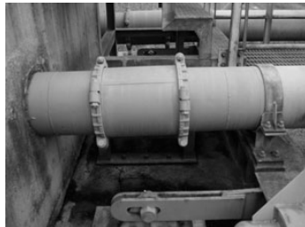
写真-1.伸縮可撓管
