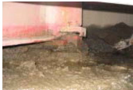
写真 - 2 支承部の劣化
