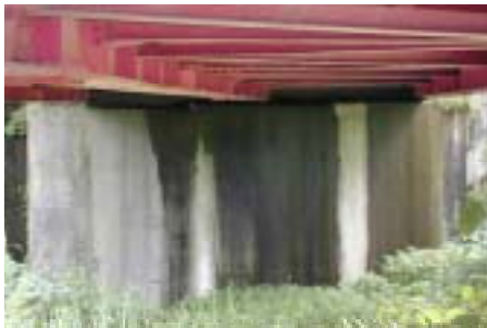
写真 - 1 凍結融解による劣化
