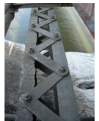
写真-3 下弦材腐食状況
