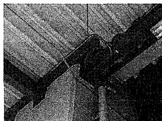
写真-1 ホーム上屋支障状況
