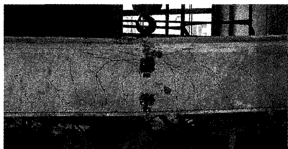
写真3 ひび割れ状況
