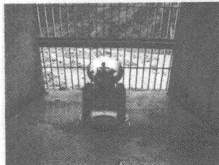
写真-4 設置状況(スクリーン背面側)
