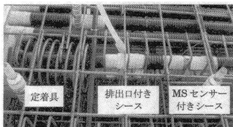
写真－1 MS センサー設置状況
