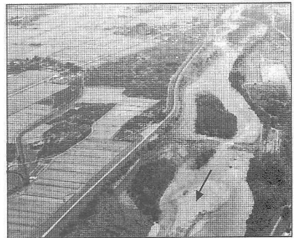
写真-1 被災した床止め（赤川22.4k付近）
