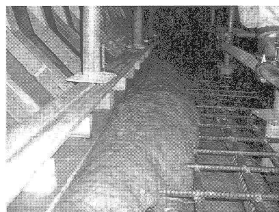
写真-2 下床版からの噴出し状況
