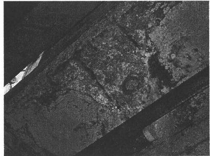
写真-1 A橋劣化状況
