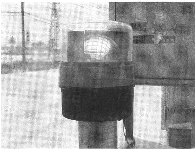
写真-5 無電極放電灯を用いた視線誘導標
