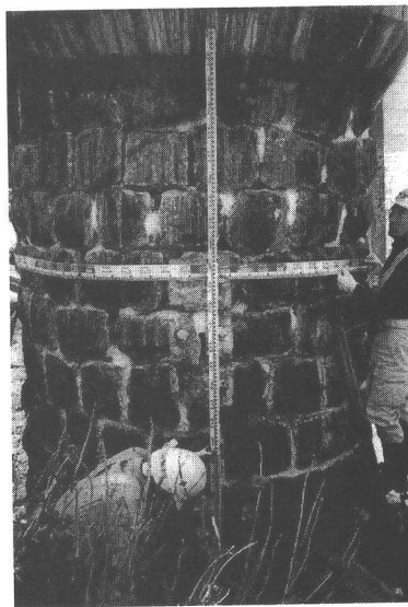
写真-1 橋脚の変状
