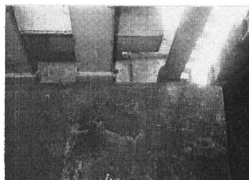
写真-3 橋桁支承部のおおり
