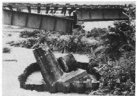
写真-1 長木川橋梁橋脚（11 p）の倒壊
