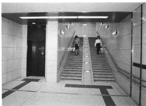
写真 ー 2 身障者・高齢者に配慮したエレベータ及び階段室
