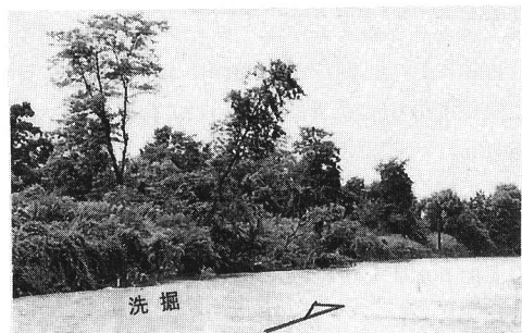
※ 第3水制先端部の樹木が洗掘により川側に倒れている。
