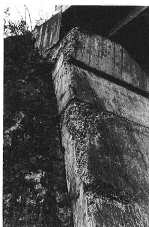
写真-2 橋台の凍害
