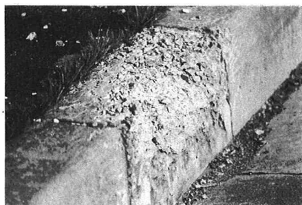
写真-4 縁石の凍害
