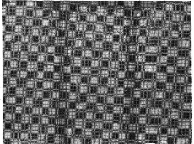
写真-2 内部ひびわれ発生状況
