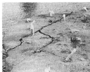
写-3 亀裂発生状況
