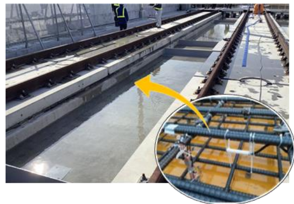
図-5 埋設センサと床版滞水状況
