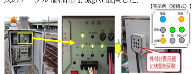
図-15 外付け表示器の設置
