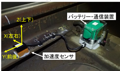
(b) センサユニットの設置状況
