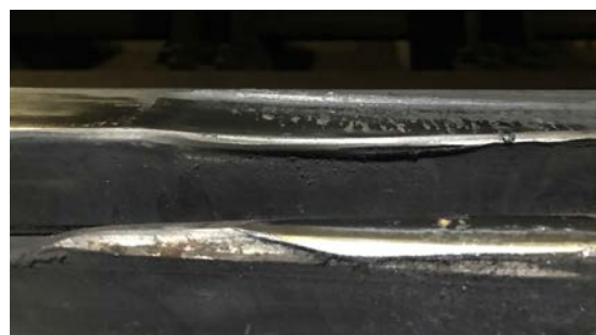
図-1 レール頭頂面の塑性変形
