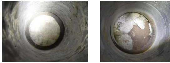
図-2 CAモルタル表層（左：隙間なし、右：隙間あり）
