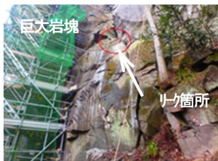
図-14 周辺亀裂からのリーク状況
