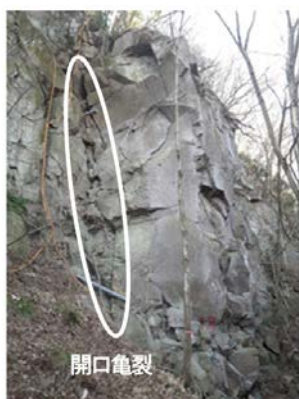
図-11 対策前の状況
