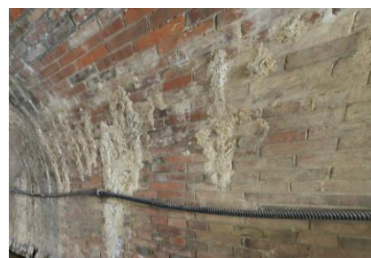
図-12 劣化部分の拡大表示
