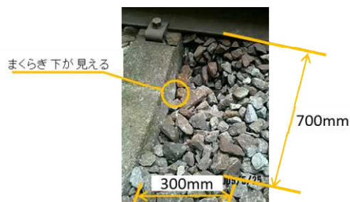
図-2 運転中止となった路盤陥没の例
