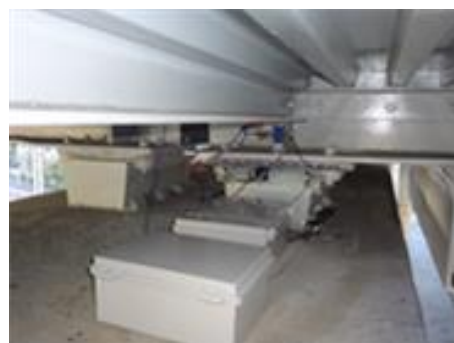
図-3 モニタリングセンサシステム設置状況
