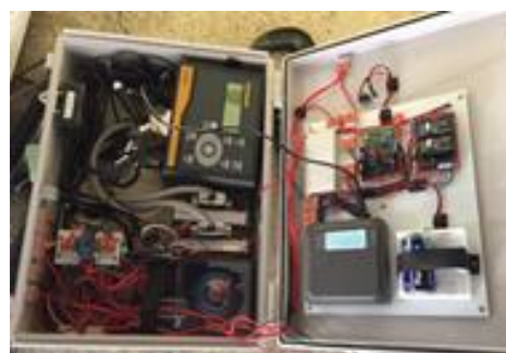
図-4 モニタリングセンサシステム測定部状況
