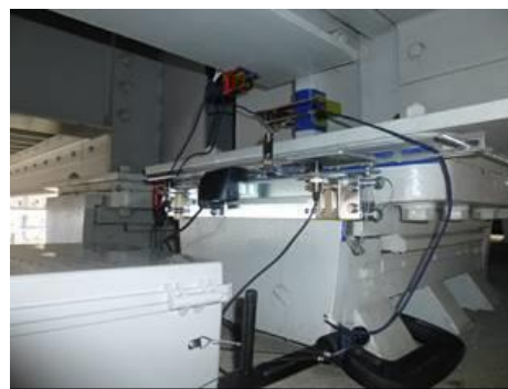
図-2 モニタリングセンサ設置状況
