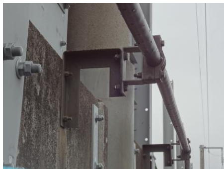
図-2 高架橋防音壁に取付けられた LCX ケーブル
