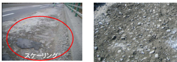
1) 凍害による鉄筋の露出 3) 2) 凍害による砂利化 写真 - 1 塩害・凍害劣化したRC床版の損傷状況
