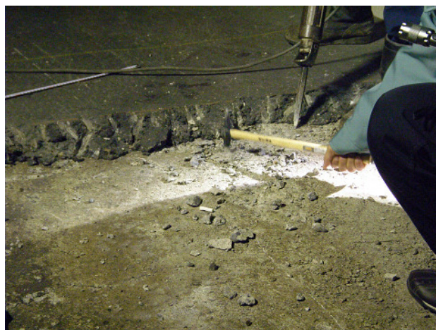
写真-1 RC 床版上面のスケーリング
