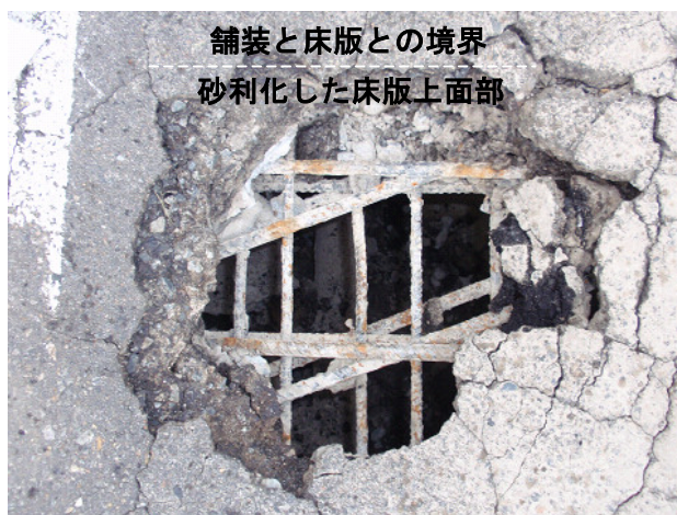
写真-3 砂利化後の押抜きせん断破壊
