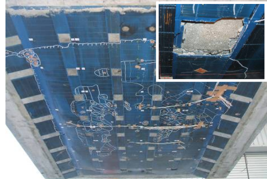
写真-7 実験終了後の補強供試体下面の破壊状況
