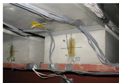
図-14 台座モルタルのひび割れ
