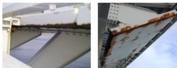
(a) ダブルフラップ (b) 下部スカート 写真－1 耐風安定化部材の腐食状況
