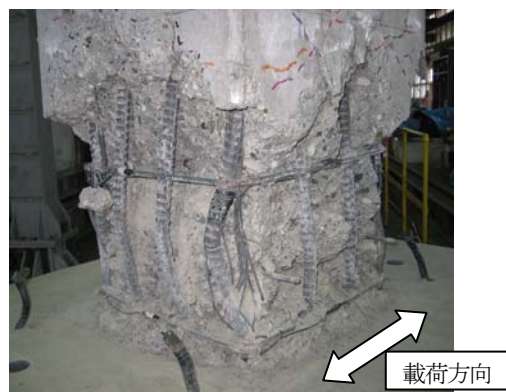
写真-8 剥離コンクリート除去後の供試体 (供試体 No. 7)
