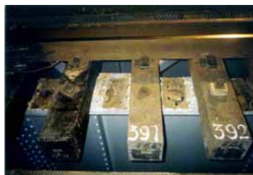
図-1 まくらぎ下の上フランジの腐食
