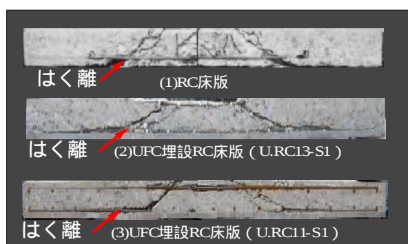
図 - 4 切断面のひび割れ状況の一例
