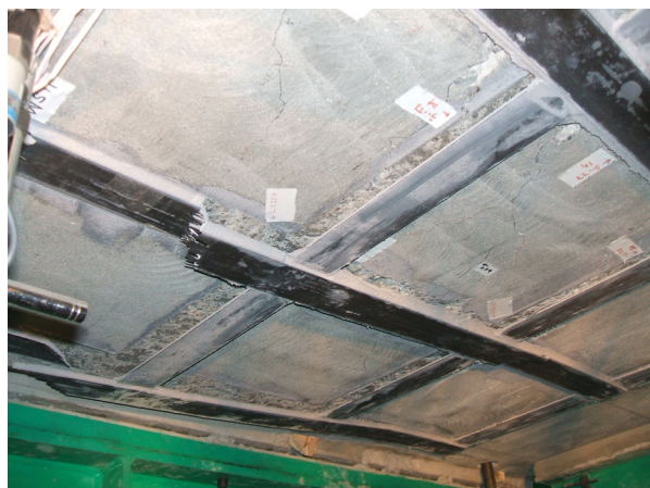
写真-9 CFRP プレートの破壊状況
