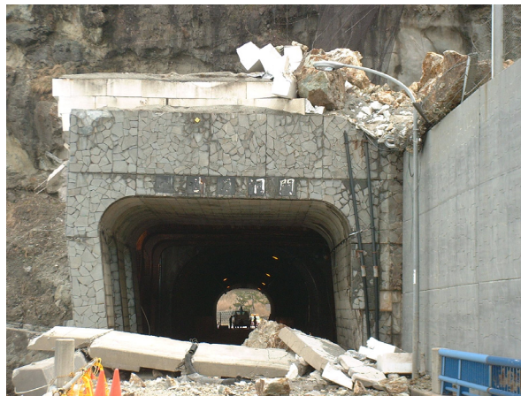
写真-1 能登半島地震で落石により大きく損傷を受けたロックシェッド (2007 年 3 月, 輪島市)
