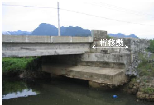
写真1 Lueng le Bridge の被害状況
