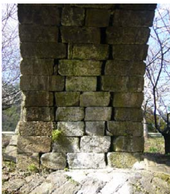
写真-1 小笹橋の損傷状況
